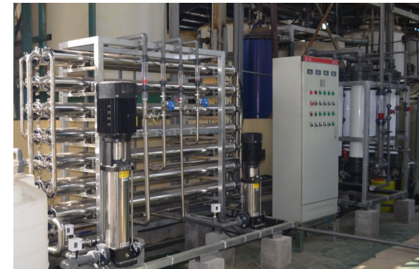
中水回用設備
