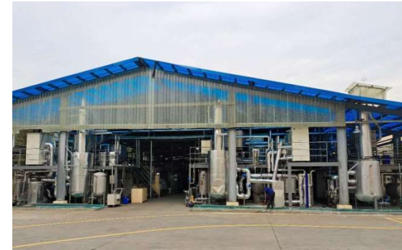
廢水蒸餾設備
